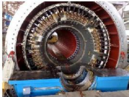
Gambar 2. Generator di dalam PLTA
