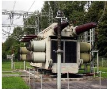
Gambar 22. Transformer Step-Up (Sumber: Wikimedia)
