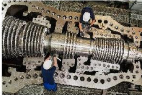
Gambar 29. Turbin (Sumber: Siemens)
